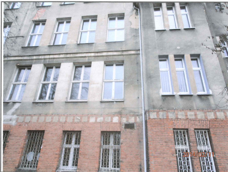
Zdjęcie nr 33. J. w. lecz widok innego pionu zarysowań na ścianie południowej starej szkoły.
