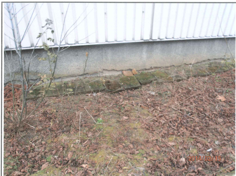
Zdjęcie nr 46 J. w. lecz widok zamoczonego cokołu i zniszczonej opaski z płytek.
