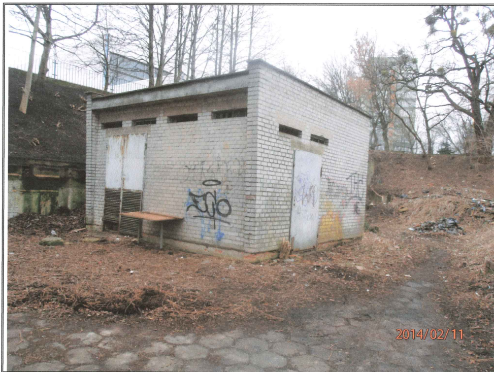
Zdjęcie nr 25. J. w. lecz widok rozdzielni.
