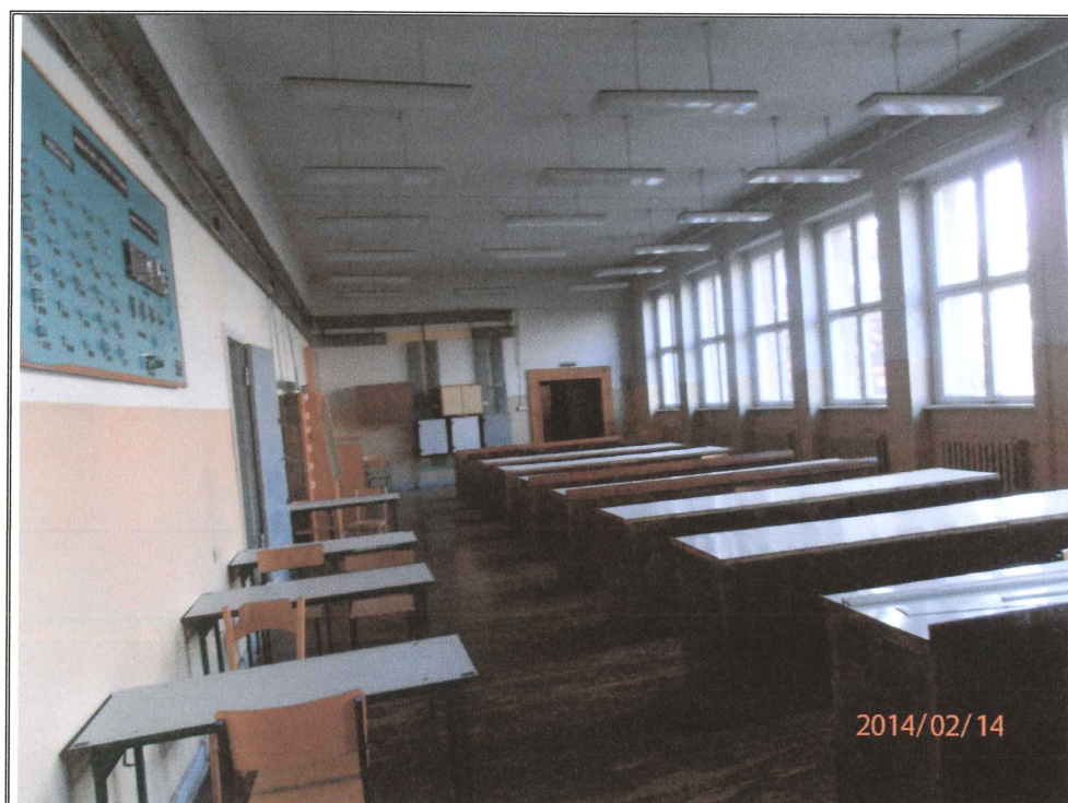
Zdjęcie nr 38. J. w. lecz widok jednego z pomieszczeń lekcyjnych na poddaszu.
