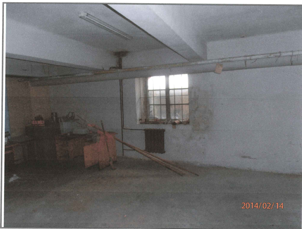
Zdjęcie nr 5. J. w. lecz fragment jednego z miejsc w piwnicy z zawilgoconą ścianą zewnętrzną.
