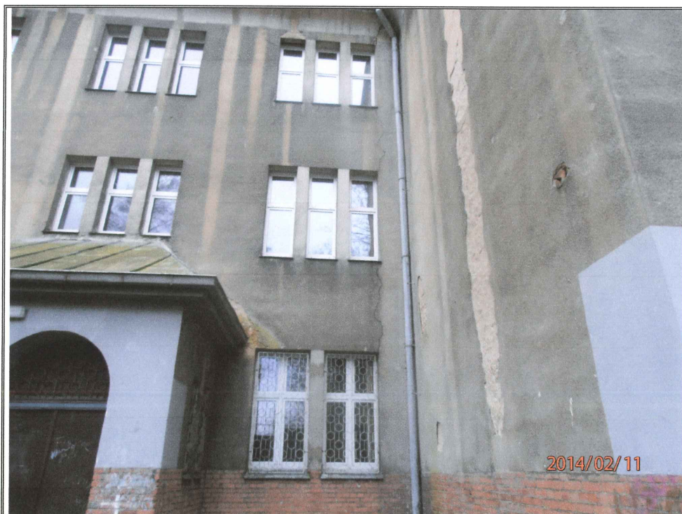
Zdjęcie nr 30. J. w. lecz widok jednego z zarysowań na ścianie od strony północnej szkoły.
