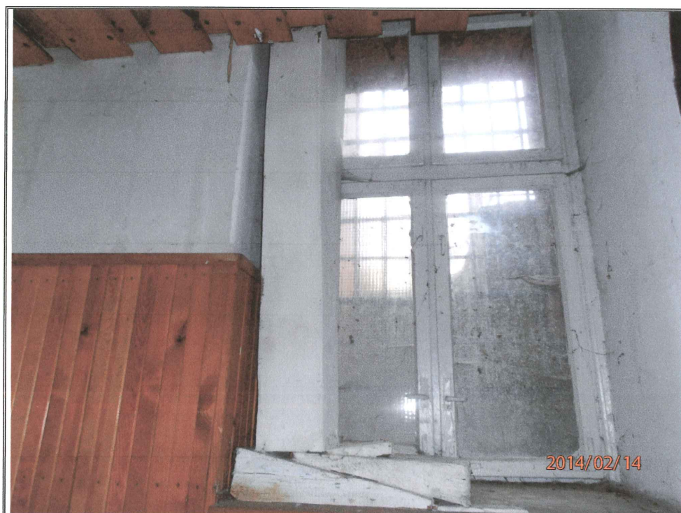
Zdjęcie nr 34. J. w. lecz fragmenty wnętrza starej szkoły. Widok podstemplowanego nadproża okiennego w piwnicy.
