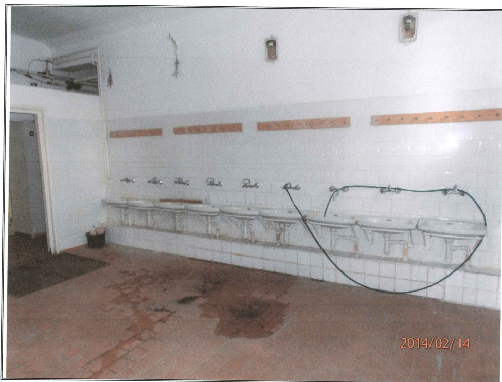
Zdjęcie nr 7. J. w. lecz fragment umywalni w piwnicy.
