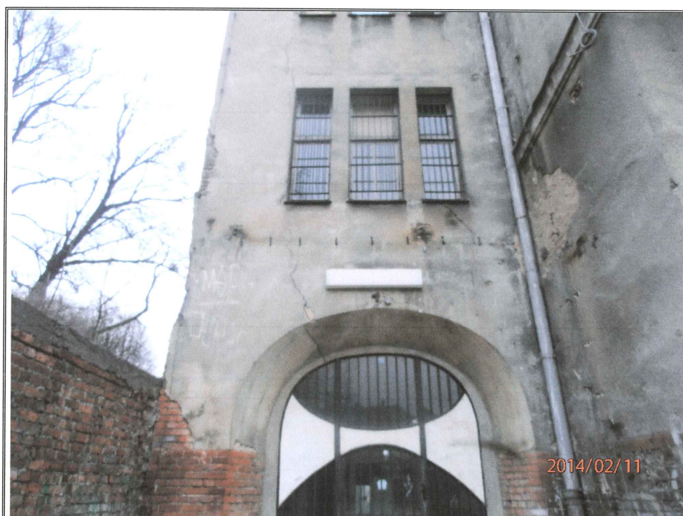
Zdjęcie nr 32. J. w. lecz widok zarysowań ściany wyłączzonej klatki schodowej starej szkoły od strony południowej.
