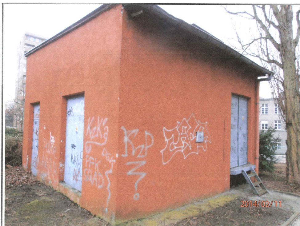
Zdjęcie nr 24. J. w. lecz widok trafostacji.
